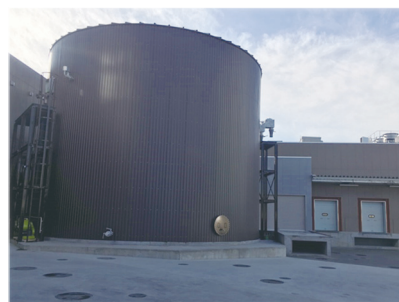
第 2 工場 バイオマスプラント
